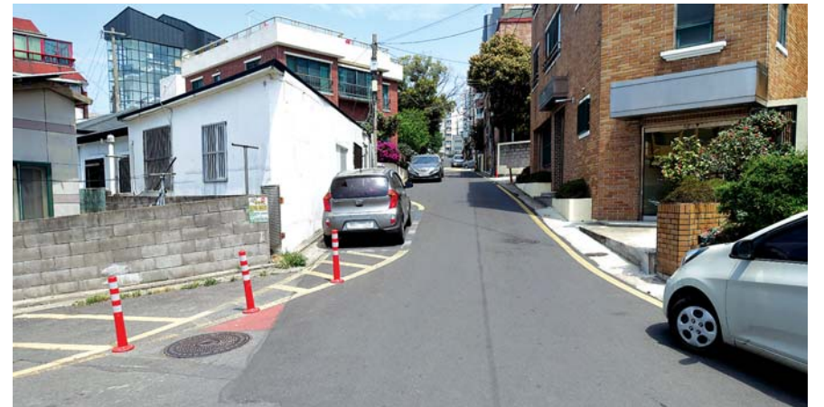
제주시 이도2동 고산동산2길 도로. 재포장된 도로 아래 미끄럼 방지 시설의 흔적이 남아있지만 원상복구 되지 않고 있다. 김현석기자
