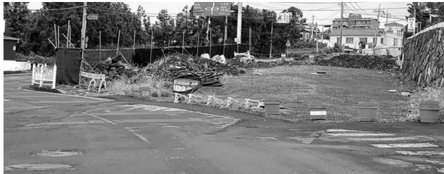
안덕초등학교와 50m 떨어진 도시계획도로 확·포장 공사 현장에 안전시설물이 미흡해 안전사고가 우려된다는 목소리가 나온다.
