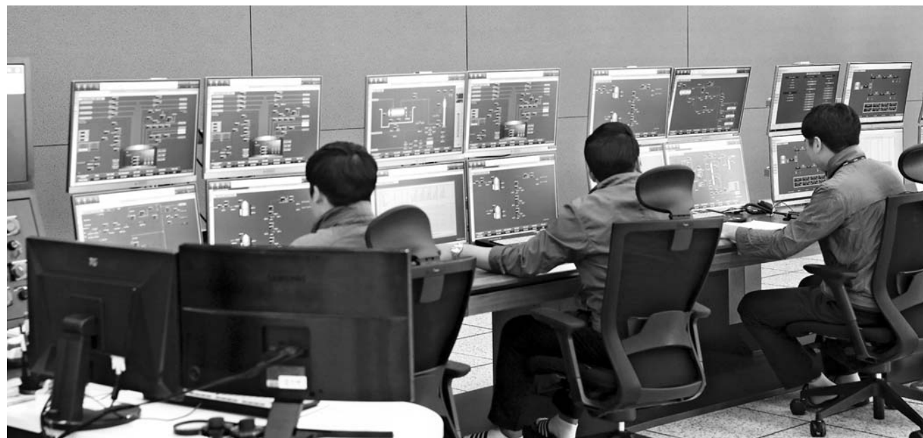
제주 LNG 인수기지 관제실 한국가스공사는 제주 액화천연가스(LNG)본부는 11일부터 제주북항발전소에 천연가스 공급을 시작했다고 14일 밝혔다. 사진은 제주시 매월을 한국가스공사 제주 LNG 인수기지 관제실의 모습. 연합뉴스
