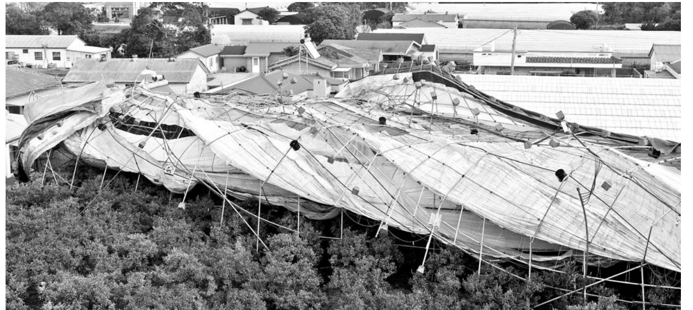
때아닌 돌풍에 파손된 감귤비닐하우스. 지난 30일 오후 6시쯤 서귀포시 남원읍 일부지역에 때아닌 순간최대풍속 15m의 극지성 돌풍이 불어 감귤비닐하우스가 파손되는 피해가 발생했다.
