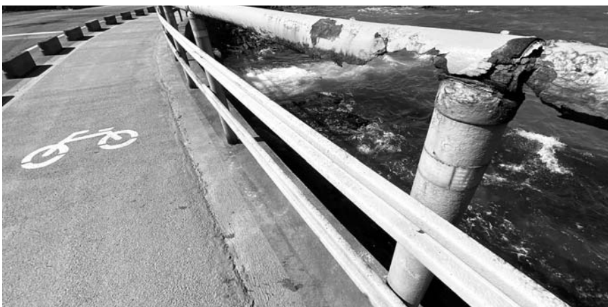
제주시 구좌읍 하도리 해안도로 환상자전거길 일대에 설치된 철제 안전펜스가 노후된 채 장기간 방치되고 있다. 이태윤기자
