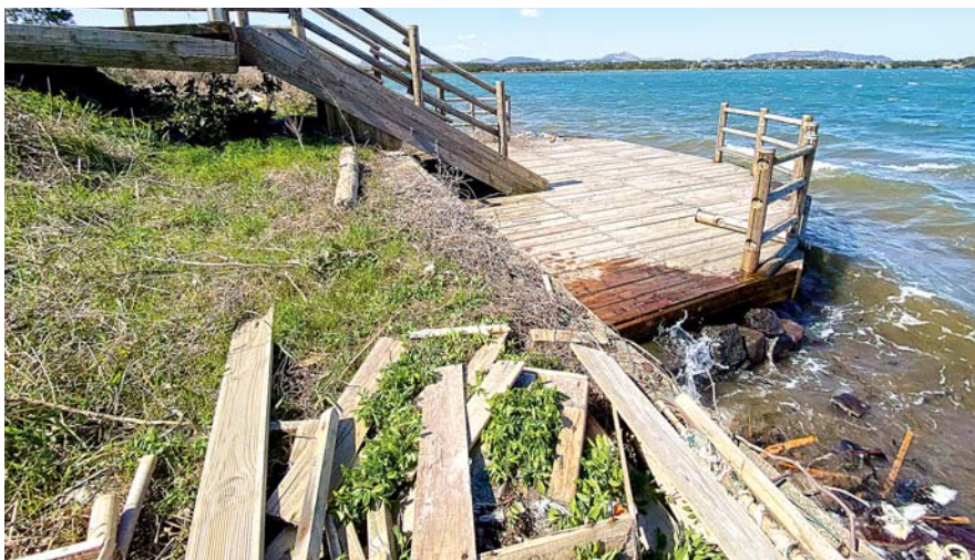
서귀포시 성산을 내수면 독방길 인근에 조성된 목재데크 시설이 파손된 채 장기간 방치되고 있어 탐방객들의 안전을 위협하고 있다.
