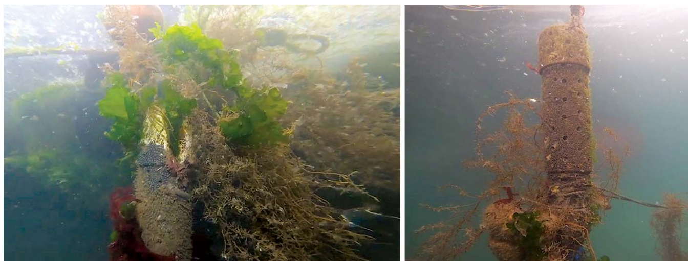
제주항 내항에 설치된 해수취수관 유입구 모습. 유입구 주변에 각종 오염물질들이 가득 차 있다.
