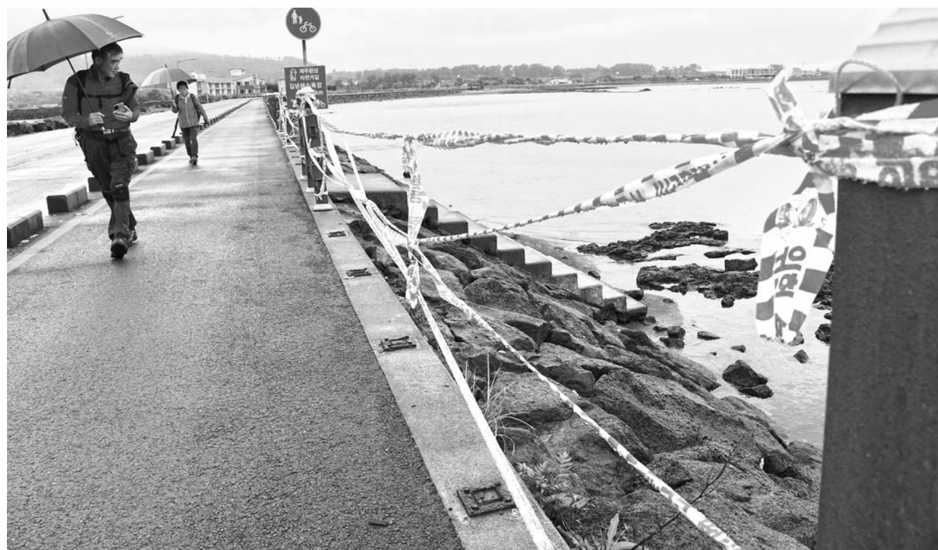
방치된 태풍 피해 흔적 16일 서귀포시 성산읍 시흥리 해안에 설치된 해안펜스가 지난 태풍에 훼손됐지만 복구가 미뤄지면서 미관 저해는 물론 안전사고 우려를 낳고 있다. 강희만기자
