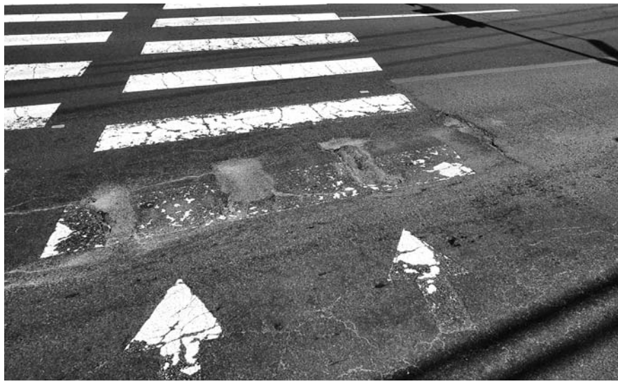
아스팔트가 길게 파여있는 도남동 우체국사거리 인근 도로.
