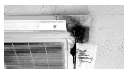
이 화재로 천장형 에어컨 실내기 3대 과 옥상 에어컨 실내기 1대가 소실된 것으로 확인됐다. 이날 화재로 2학년 학생들은 전부 귀가조치됐다. 강민성기자
