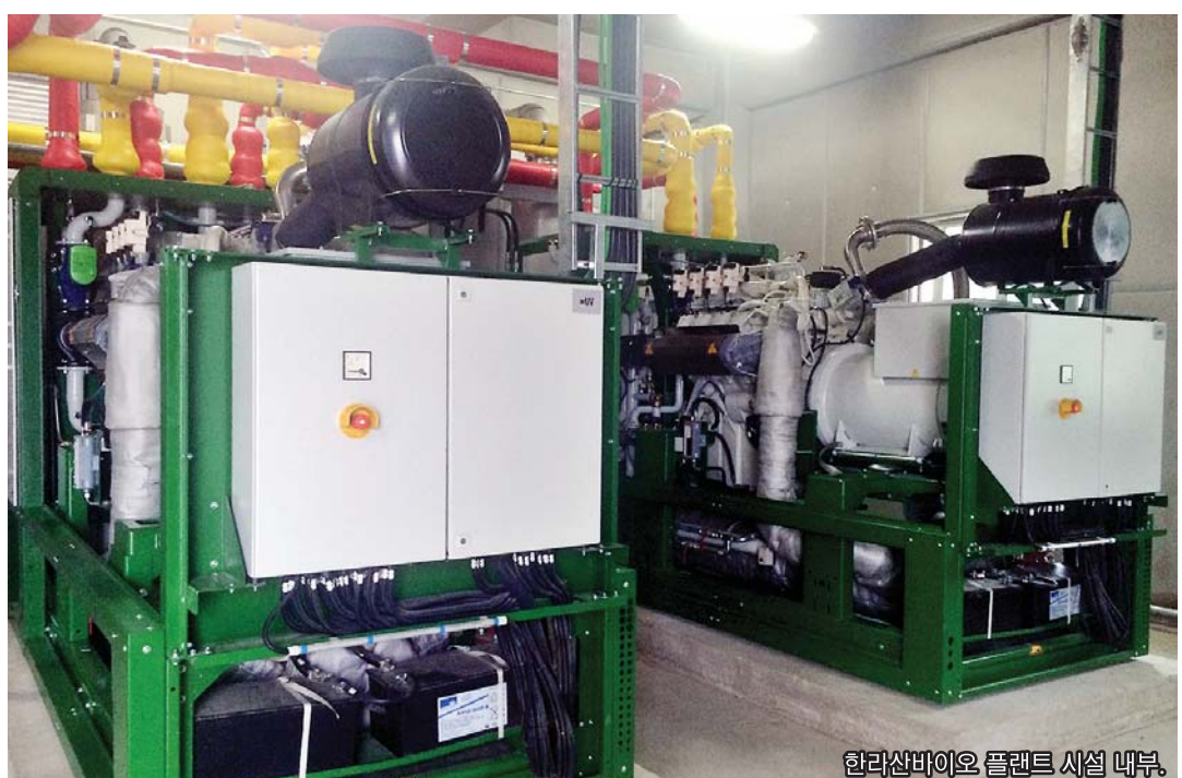
한라산바이오 플랜트 시설 내부.
