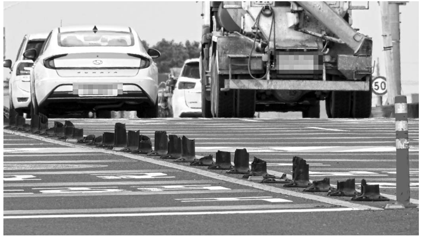
파손된채 방치된 중앙분리대 6일 제주시 구좌읍 세화리 진입로 일부 구간엔 설치된 중앙분리대가 파손된채 장기간 방치돼 있다. 강희만기자
