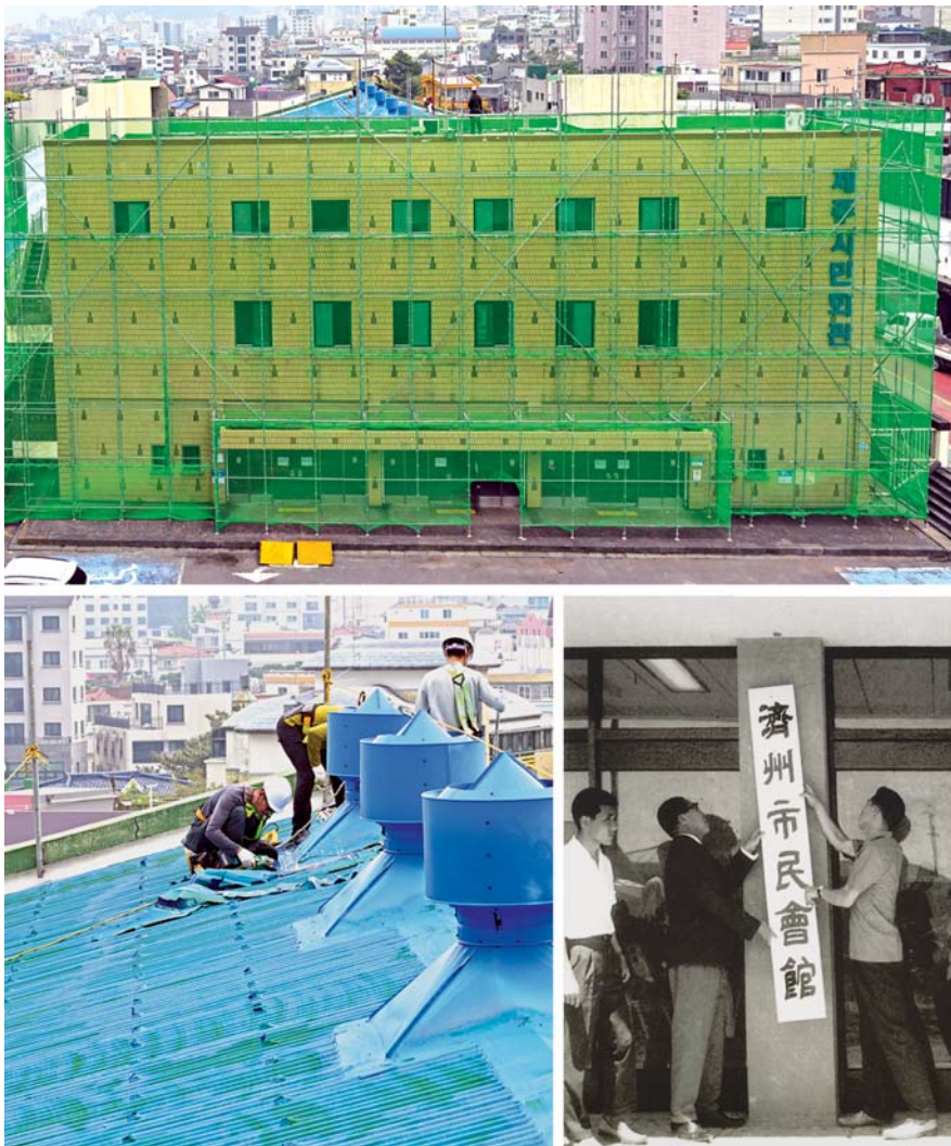
낙하물 방지망이 씌워진 제주시민회관(사진 맨 위)과 15일부터 진행되고 있는 지붕 해체 작업(사진 아래 왼쪽). 1964년 7월 열린 제주시민회관 현판식(사진 아래 오른쪽). 1964년 문을 연 시민회관이 기억을 품고 역사의 뒤안길로 사라지는 순간이다. 이상국기자
