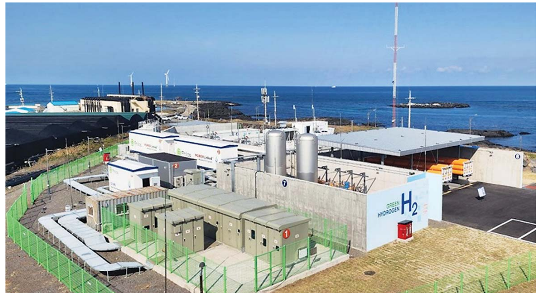
제주시 구좌읍 행원리 행원풍력단지 내 그린수소 생산시설.
