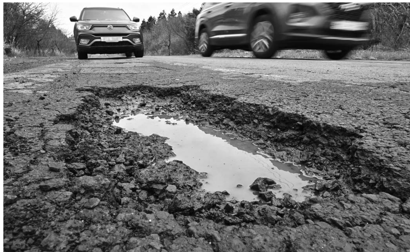
안전운행 위협하는 포트홀 5일 제주 산간도로인 녹산로에 해빙기를 맞아 포트홀(도로 파임)로 인해 차량 통행에 지장을 초래함은 물론 교통사고 위험성이 높아 운전자의 주의가 필요한 실정이다. 김희만기자
