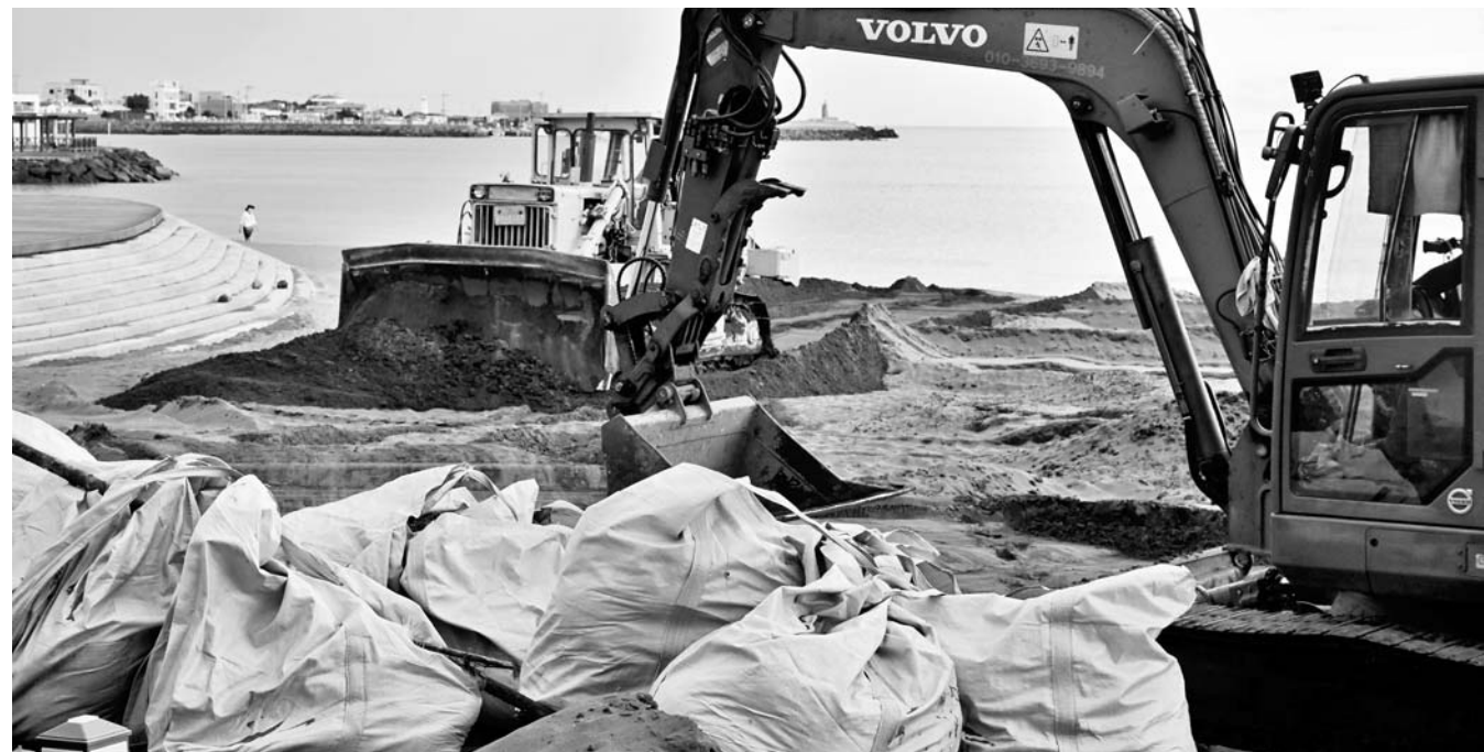
삼양해수욕장 개장 준비 17일 제주시 삼양동 삼양해수욕장에서 중장비를 동원해 개장 준비 작업을 하고 있다. 강희만기자
