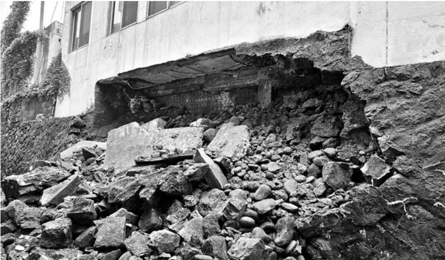
4일 오전 9시58분쯤 무너져 내린 서귀포시자치경찰대 건물.
